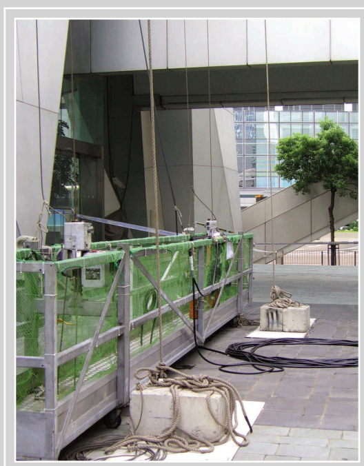
吊船工人使用的獨立救生繩 尾端在地面以石矢臺錨定
