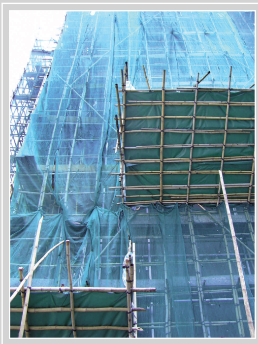
固定式棚架及工作台
