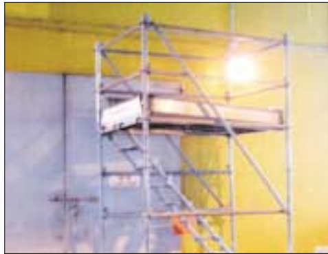
流動金屬通架工作平台應設有護欄、底護板和上落爬梯*，並採取有效措施，以確保棚架的穩固性。
