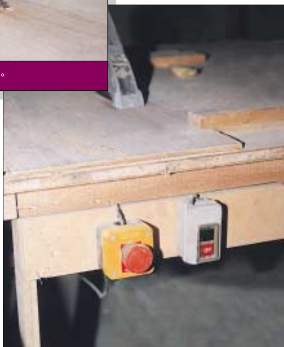
風車鋸應設有有效開關掣及緊急停機裝置。
